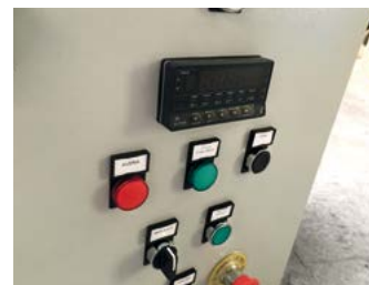
Armario eléctrico de control
