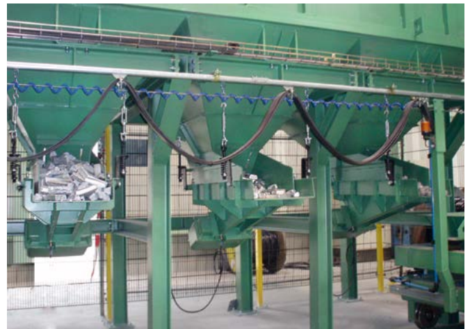
Instalaciones ferroaleaciones Ferroalloys dosing system
