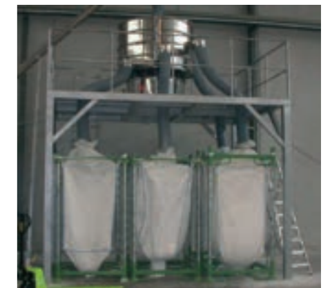
Tamizado para separación de carga en BIG BAGS con tamizadora FTI-1200 con tres separaciones en línea de PET reciclado con rendimiento superior a 2.000Kg/hora.
